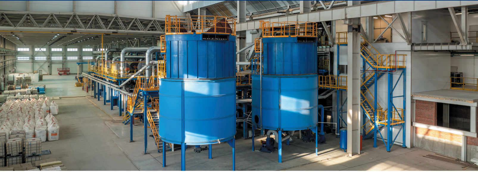
Завод теплоизоляционных материалов из минеральной ваты, производственная линия
