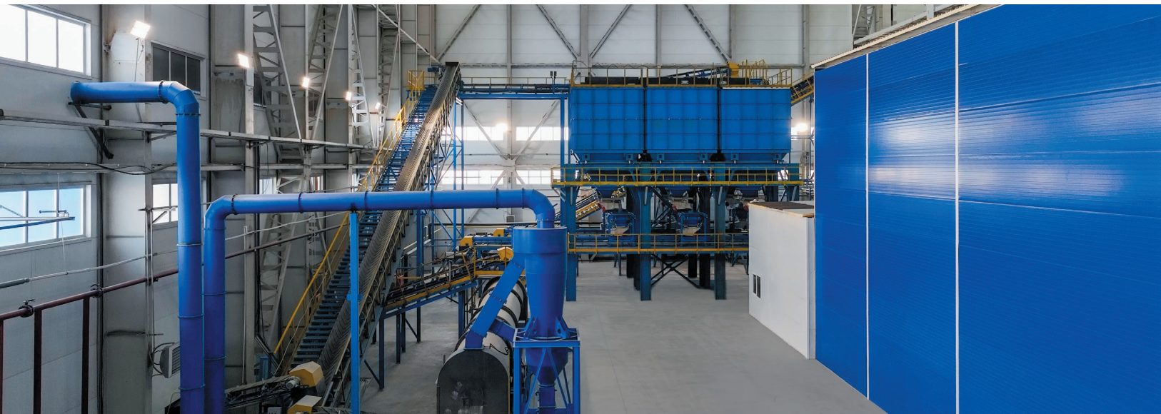
Завод теплоизоляционных материалов из минеральной ваты, конвейер шихтоподачи
