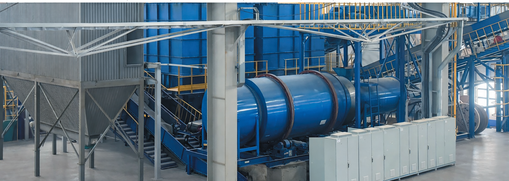
Завод теплоизоляционных материалов из минеральной ваты, сушильный барабан
