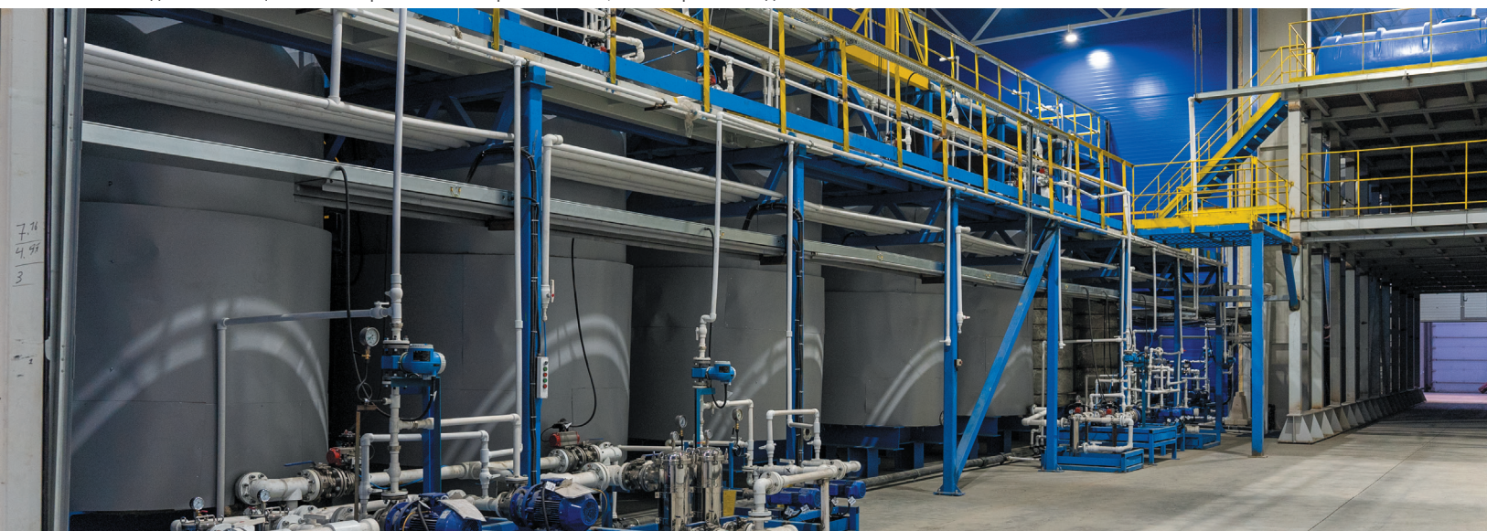
Завод теплоизоляционных материалов из минеральной ваты, участок приготовления связующего
